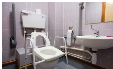
Thiết bị nhà tắm và toilet
